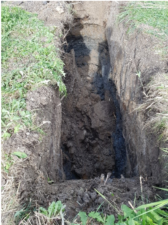
Figuur 5: sleuf in niet-behandelde bodem: na 3 uur reeds deels ingestort
